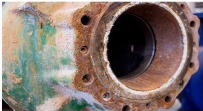
الشكل (5) يوضح التآكل في المضخات
