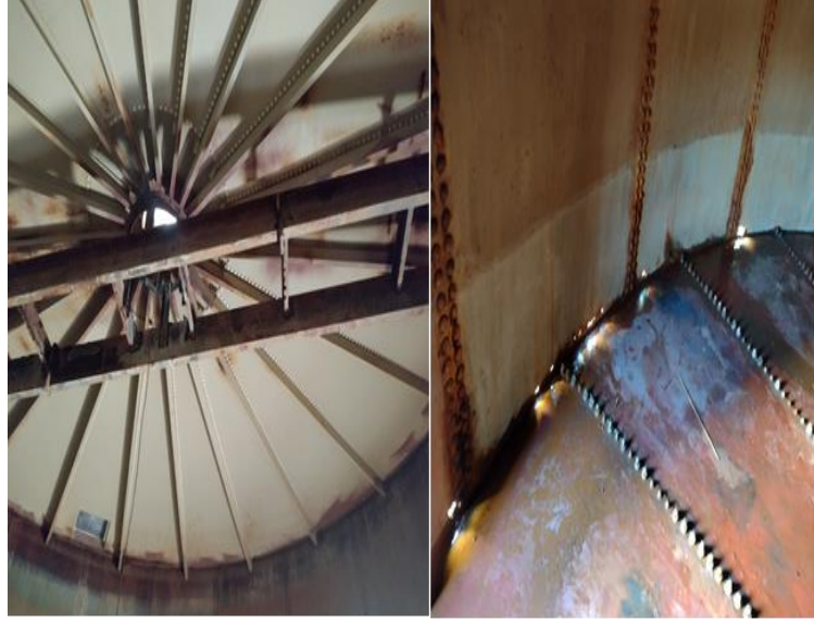
الشكل (6) التآكل في الخزانات
